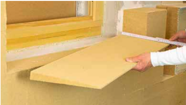
1 Bündiger Zuschnitt des STEICOtri Holzfaser-Dämmkeils auf die passende Länge und Tiefe der Fensteröffnung
